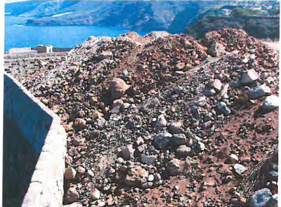
Rellenos realizados sobre los muros cortavientos, de baja capacidad estructural y en el borde del Espacio Natural a retirar.
