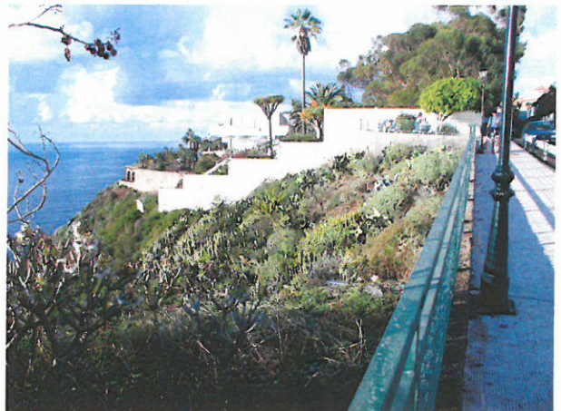
Foto del estado actual del Mirador del Michel, con materiales degradados.
