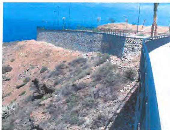
Muros de urbanización La Quinta Roja, con restos y vertidos de la construcción que es necesario limpiar.
