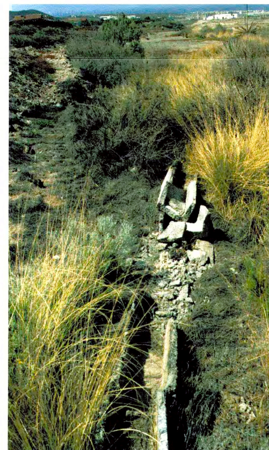
Foto 6: Detalle de un tramo de atarjea deteriorado por el paso del tiempo, que en su momento transportaba agua hacia las parcelas agrícolas cultivadas existentes en el interior del ámbito. Ésta, así como las restantes, serán debidamente retiradas de la superficie a urbanizar y gestionadas adecuadamente. En el margen derecho de la foto aparece una de las palmeras que se protegerán de las acciones previstas por el Plan, debido al buen estado de conservación que presenta.
