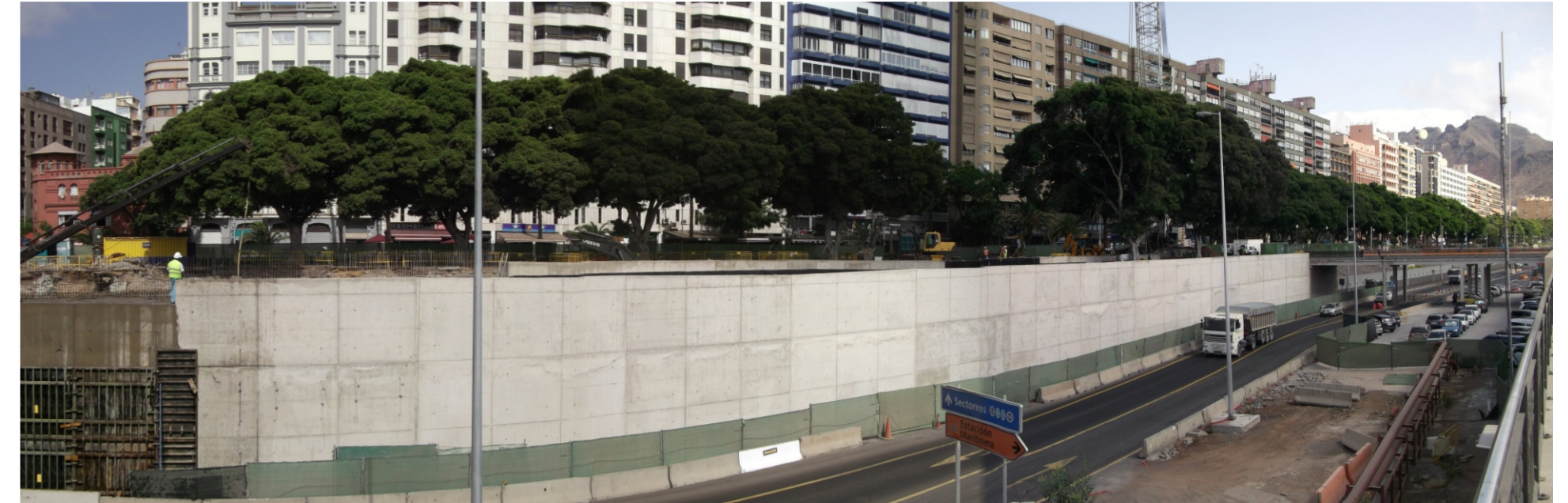
Vista panorámica donde se observa la vía de servicio y las obras que se están ejecutando en la Avenida de Anaga.
