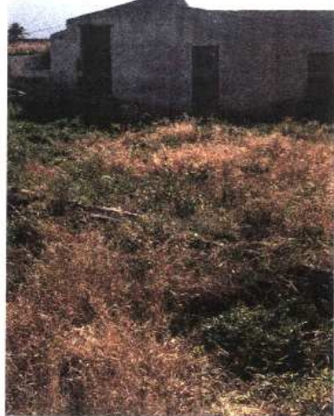
FOTO1: Edificación existente en el área que se encuentra en estado ruinoso, la cual deberá ser demolida y los restos de la misma llevados a vertedero autorizado. En la imagen también se puede observar una antigua canalización de agua (atarjea) que se encuentra en desuso. Además en esta foto se aprecia la vegetación existente en la zona que no presenta valores significativos.
