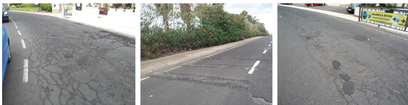
Imagen: Calzadas en mal estado de conservación. Elaboración propia.
