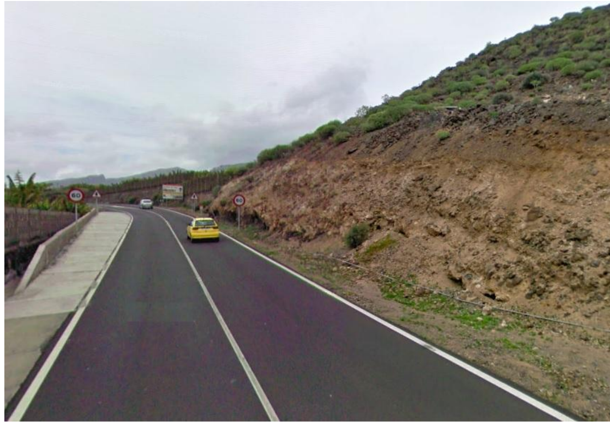
Imagen: Talud inestable en TF-46. Fuente: Propia
