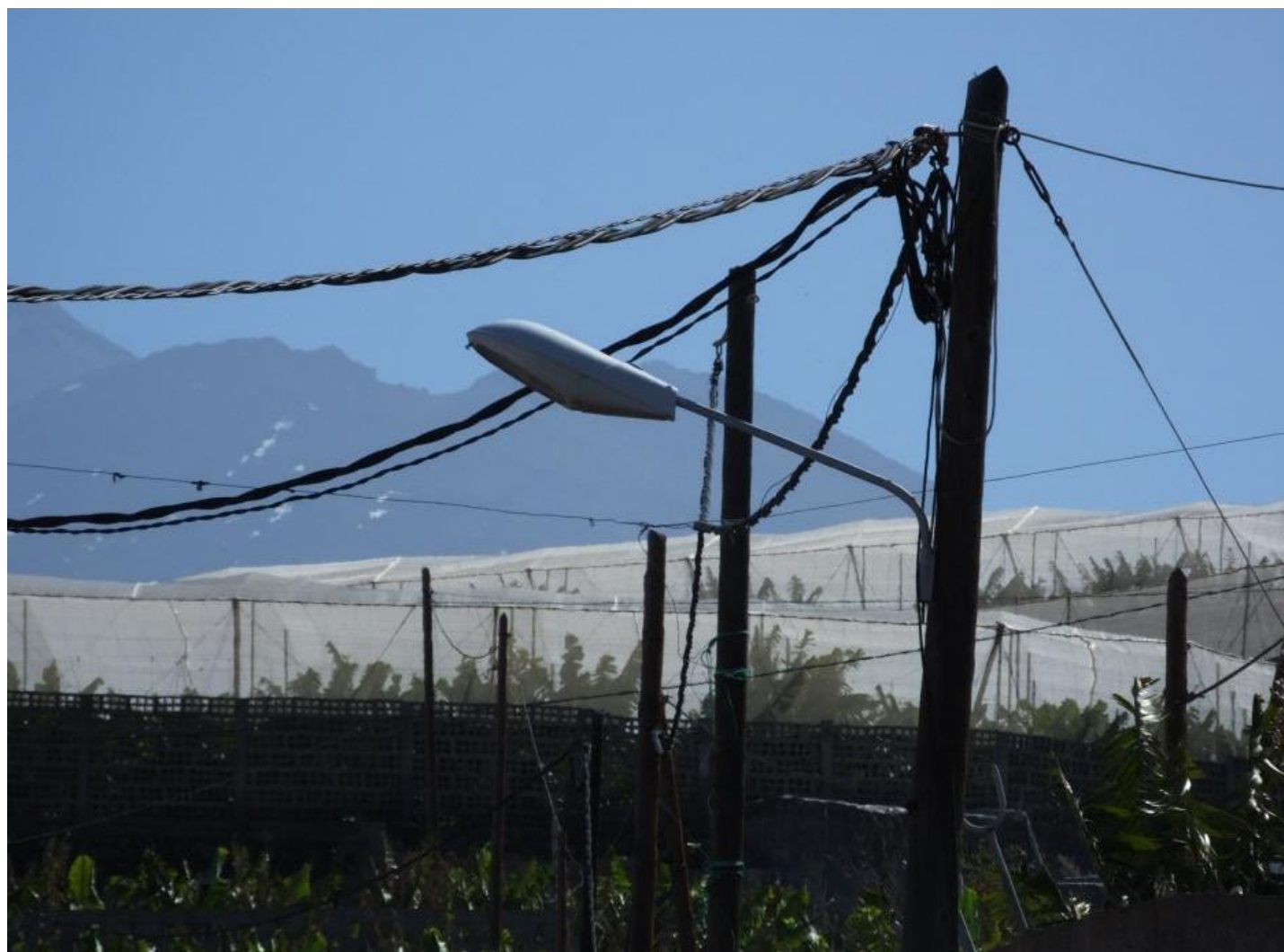
Imagen: Cableado aéreo en la zona de Cueva del Polvo. Fuente: Propia
