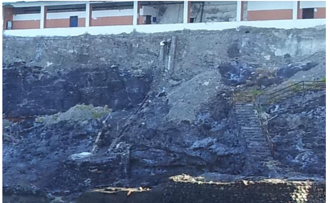
Imagen: Aliviadero de aguas residuales Hotel Stil Los Gigantes. Fuente: Propia.
