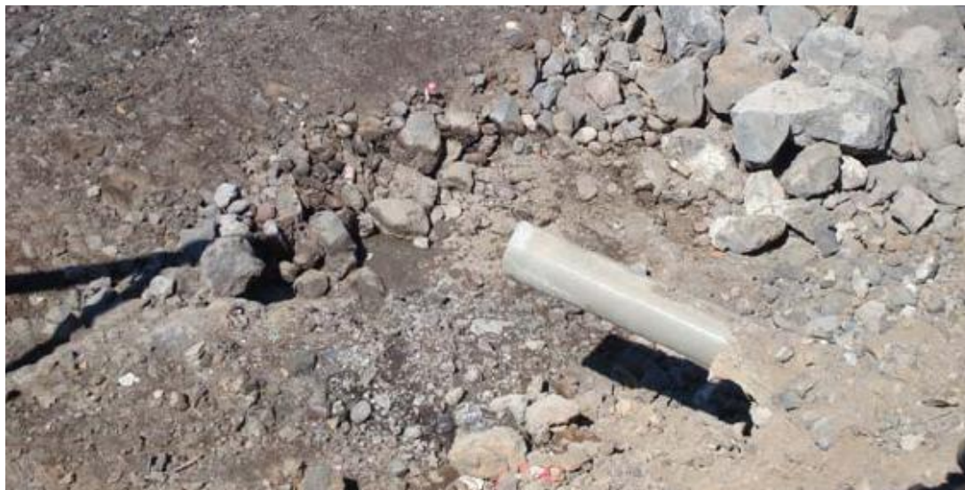
Imagen: Conducción de desagüe bajo la plaza de la Herradura, Puerto Santiago. Fuente: Propia.
