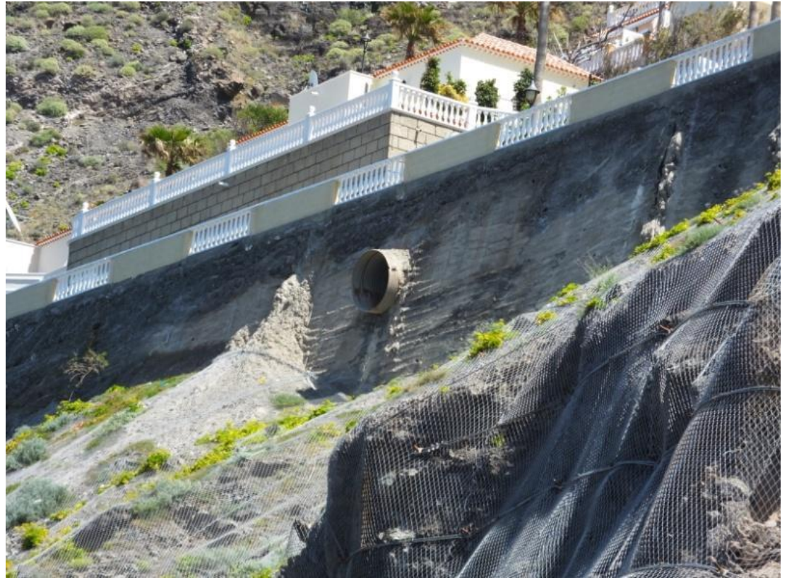
Imagen: Aliviadero de aguas pluviales sobre la playa de Los Guíos. Fuente: propia.
