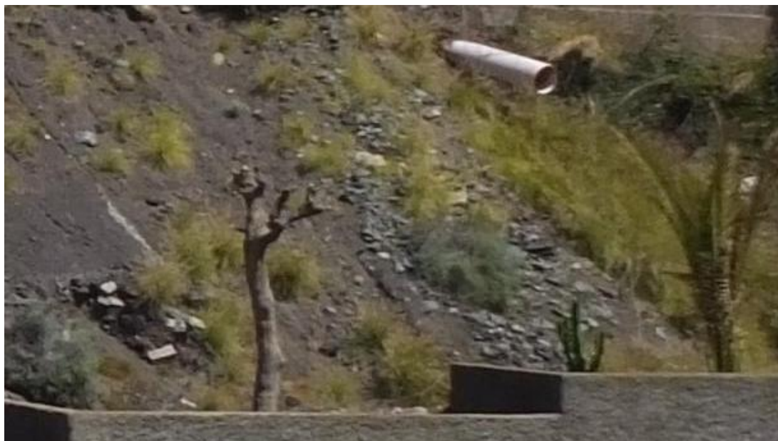
Imagen: Conducción abierta de aguas pluviales. Fuente: propia.
