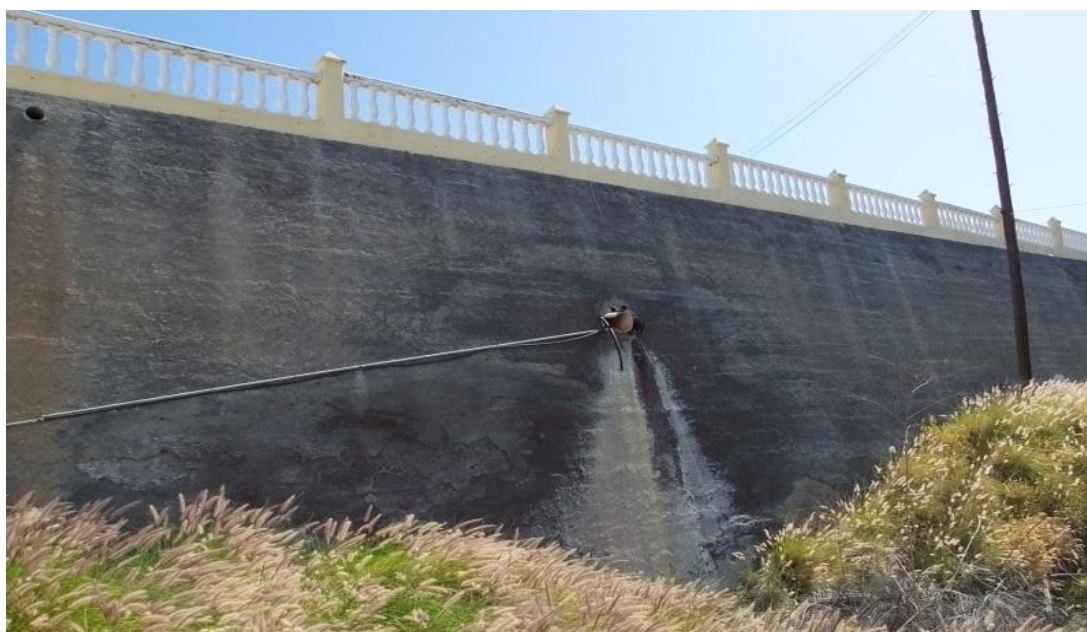
Imagen: Aliviadero red saneamiento Varadero. Fuente: Propia.
