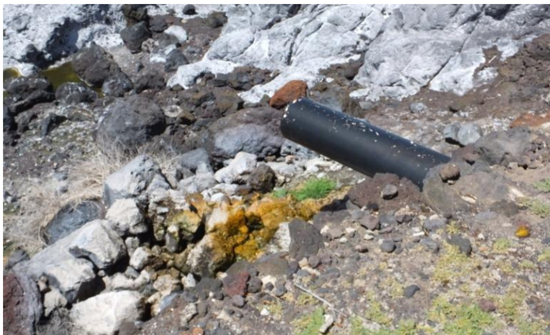
Imagen: Aliviadero activo cerca del paseo marítimo de Puerto de Santiago. Fuente: Propia.
