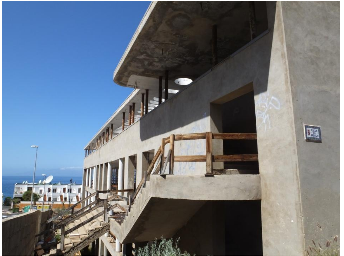
Imagen: Edificio en obras abandonado en Avenida Marítima de Puerto Santiago
