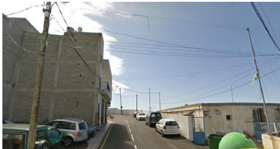
Imagen: Tendido eléctrico y telefónico aéreo. Cueva del Polvo. Guía de Isora. Fuente: propia
