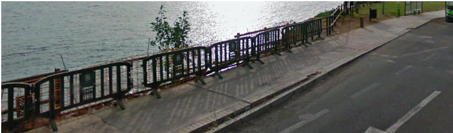
Foto: Aceras en mal estado de conservación. La Caleta. Fuente: Propia
