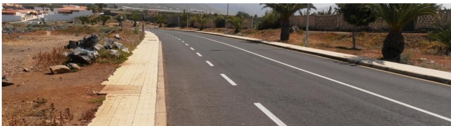
Foto: Aceras mal estado de conservación. Fuente: Propia
