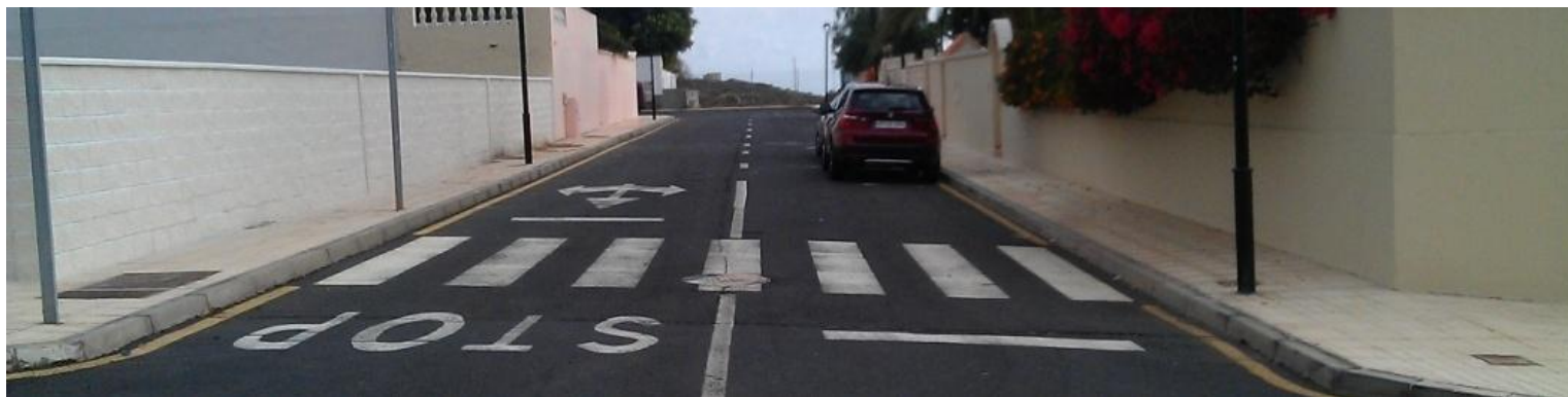
Foto: Paso de peatón sin adaptar. Fuente: Propia
