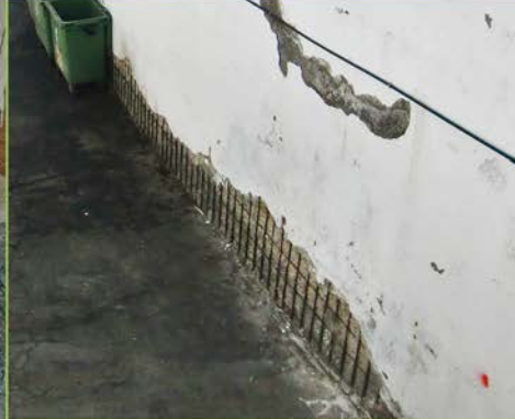
ESTRUCTURA. Muros de contención de tierras en el perímetro con armaduras vistas, eflorescencias y pérdida de sección del hormigón.
