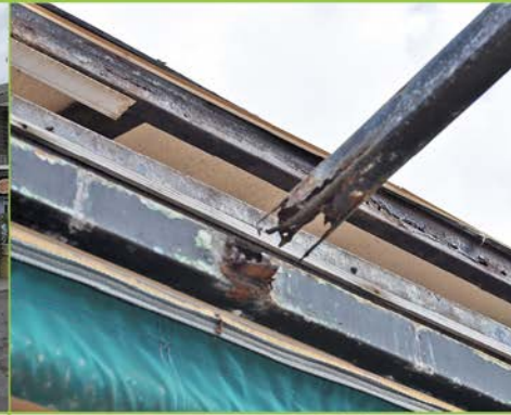
ACABADOS. Péximo estado de mantenimiento de interiores y exteriores del edificio, con elementos de cubrición en estado ruinoso.
