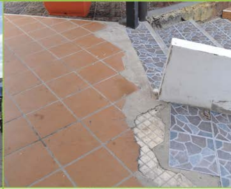
PAVIMENTOS. Numerosidad de soluciones de pavimentación que menoscaban la imagen unitaria del inmueble.
