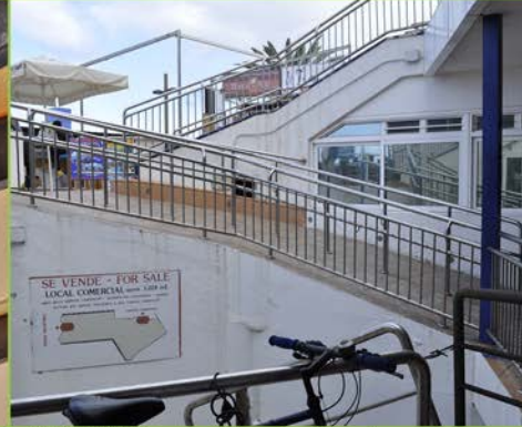
ACCESIBILIDAD. Rampas mal dimensionadas en los accesos, discontinuidad del recorrido adaptado, ascensor fuera de la parcela.
