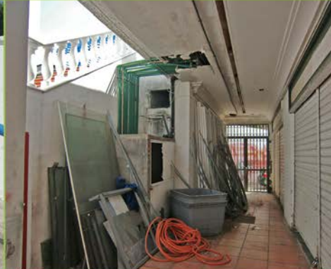
TRANSITABILIDAD INTERIOR. Invasión de espacios comunes, por almacenamiento de escombros y expositores que dificultan el paso.
