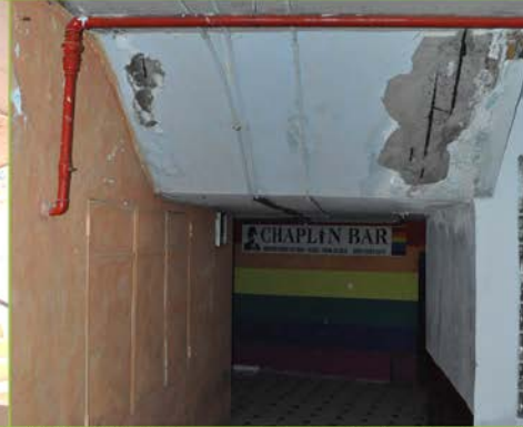
INSTALACIONES. Problemas estructurales debido a filtraciones de aguas. Instalaciones eléctricas en mal estado o inexistentes.
