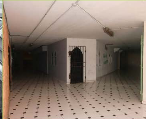
FUNCIONALIDAD. Accesos poco claros, interiores sin iluminación natural, recorrido accesible inexistente. Modelo funcional obsoleto.
