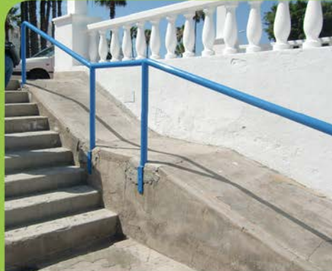
CIRCULACIÓN VERTICAL. Escaleras sin revestir y mal dimensionadas, rampas de excesiva pendiente y falta de ascensores.
