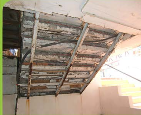
ESTRUCTURA. Graves problemas de corrosión en elementos estructurales metálicos por falta de mantenimiento.
