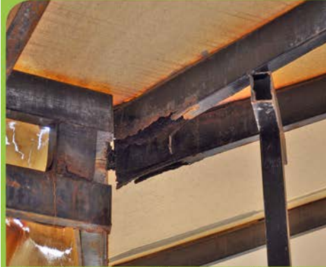
ESTRUCTURA. Estructuras metálicas con graves problemas de corrosión por exposición a ambiente marino.
