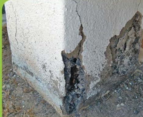
ESTRUCTURA. Corrosión y pérdida de sección en armaduras de pilares, presentando fisuración y reparaciones de baja calidad.
