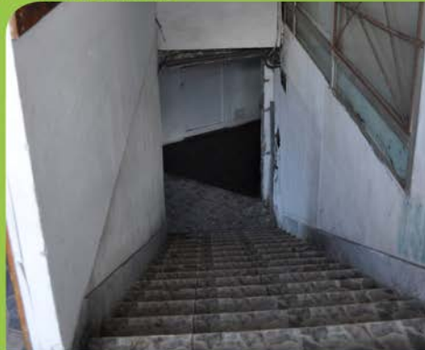
CIRCULACIÓN VERTICAL. Escaleras mal dimensionadas y trazadas, falta de claridad en el recorrido entre plantas.
