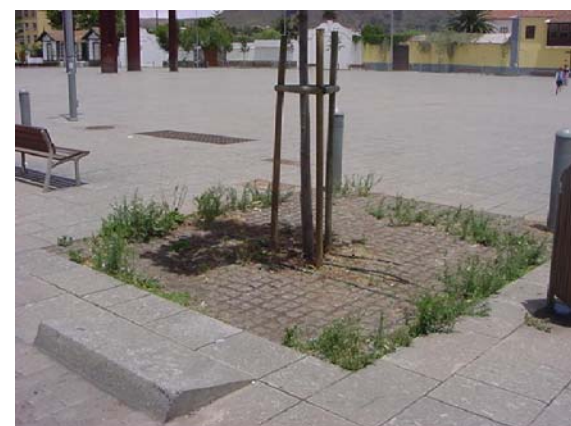
4 ELEMENTOS QUE DIFICULTAN LA CIRCULACIÓN
