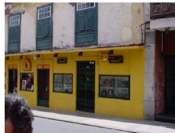
3 FACHADA DE PLANTA BAJA ALTERADA POR COMERCIO
