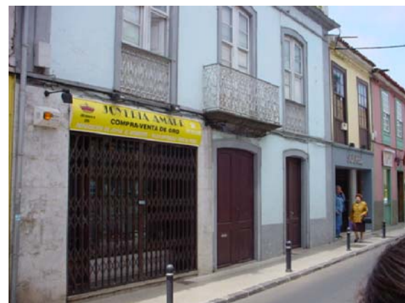
5 PÉRDIDA DE TIPOLOGÍA EN PLANTA BAJA
