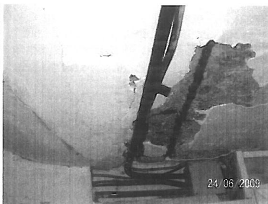
Foto: Vista Cata en techo con armadura corroída a la vista
