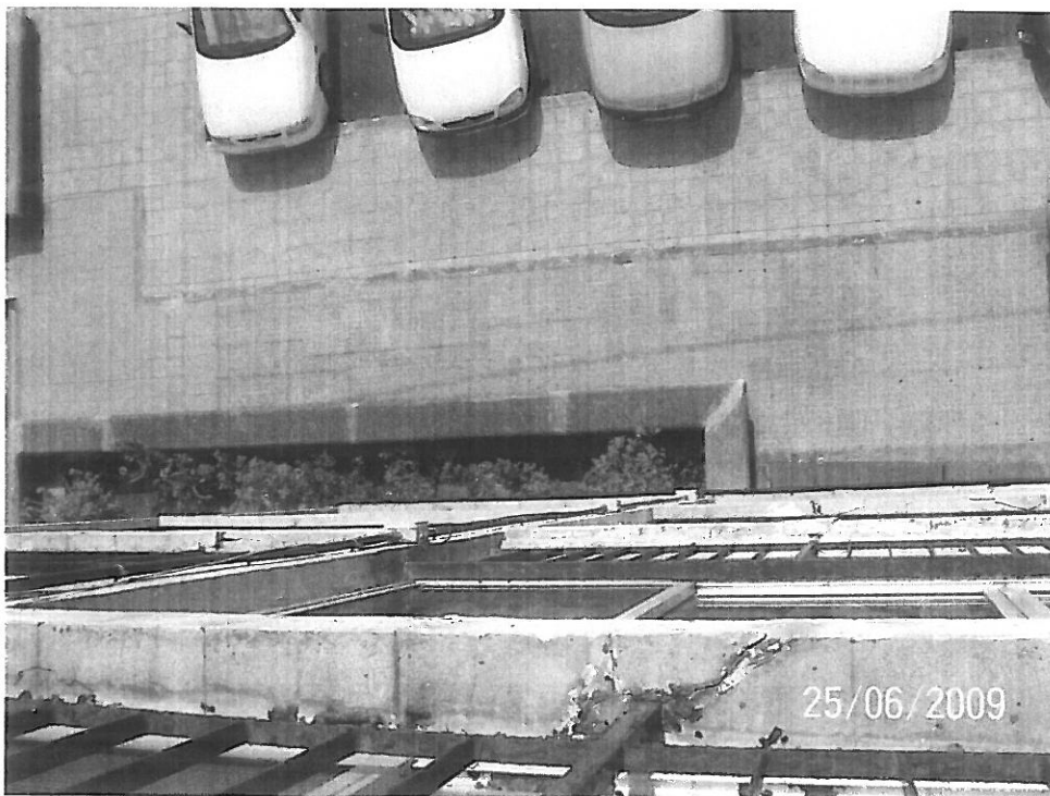
Foto: Vista detalle corrosión de barandilla y rotura en zona de anclaje
