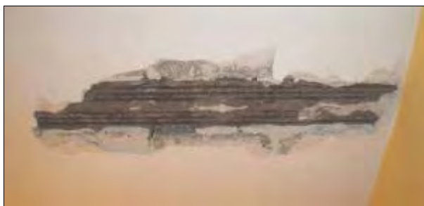
Estado de los alambres al abrir la cala
