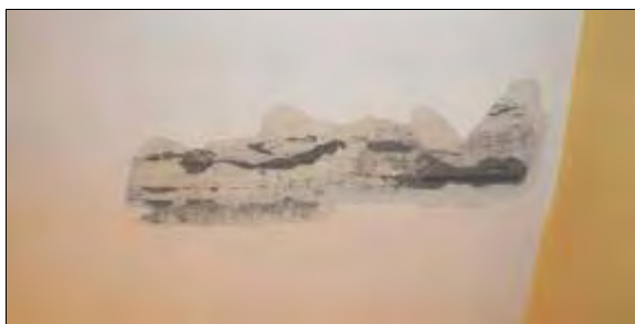
Estado de la vigueta al retirar acabados
