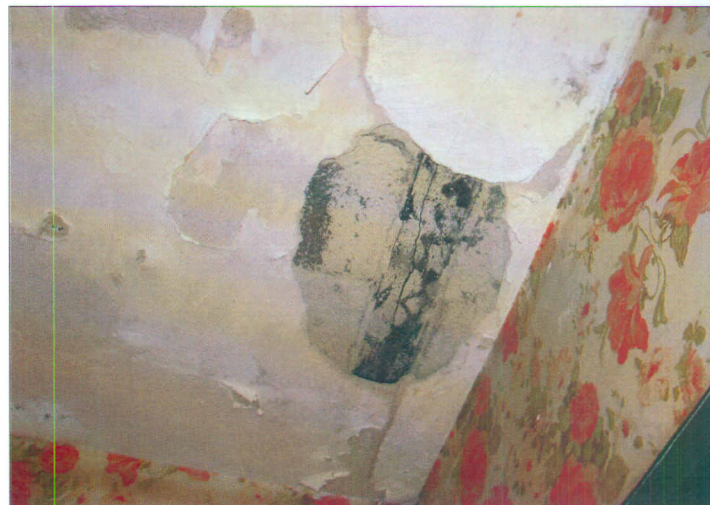
Fisuras en cara inferior de viguetas, marcando la posición de las armaduras. Se presentan con carácter puntual en algunos de los bloques
