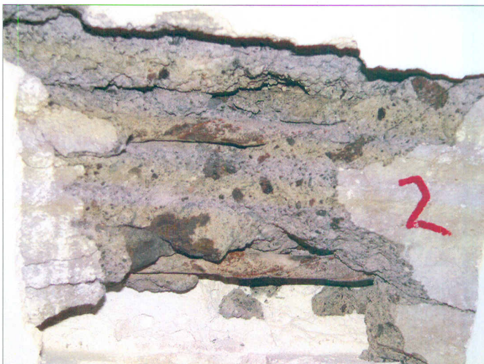
Véase la coloración gris clara del hormigón de la vigueta
