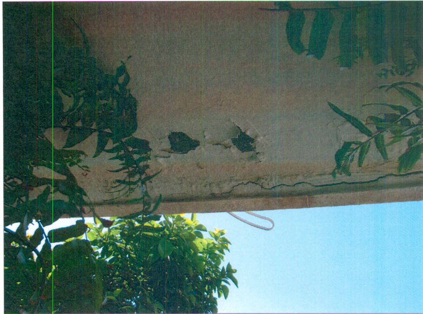
Deterioro de acabados exteriores de fachada en bordes de forjados
