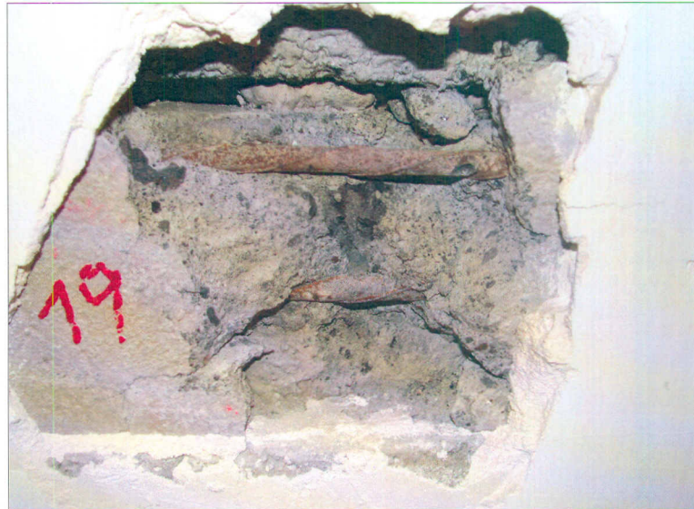
Vista de una cala realizada en cara inferior de una vigueta prefabricada de hormigón armado, aparentemente con sección en doble T
