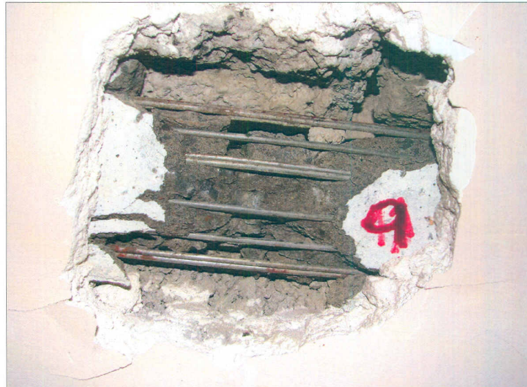
Vista de una cala realizada en cara inferior de una viga prefabricada pretensada con sección en doble T
