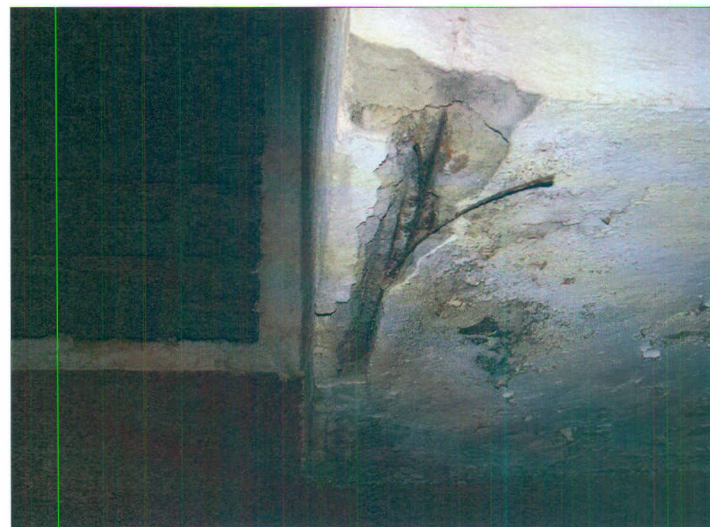
Desconchones en cara inferior de las viguetas dejando a la vista su armadura. Se presentan con carácter puntual en algunos de los bloques
