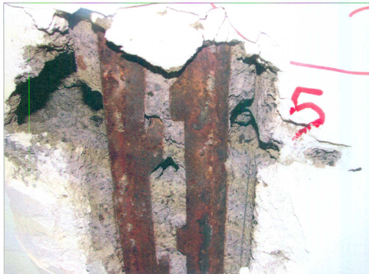
Vista de una cala realizada en cara inferior de una vigueta prefabricada de hormigón armado, con pletinas ( fleje ) en cara inferior
