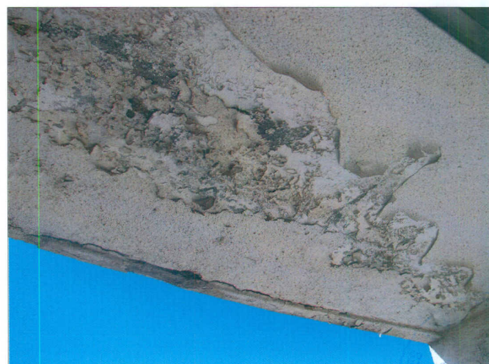
Humedades en techos. Fundamentalmente se localizan en terrazas, baños y cocinas
