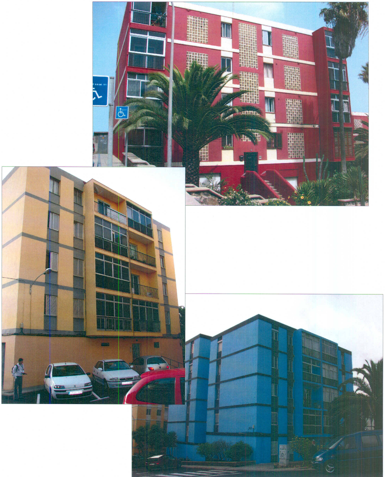
Vistas de algunos de los bloques en estudio. Obsérvese las diferentes configuraciones en planta y altura
