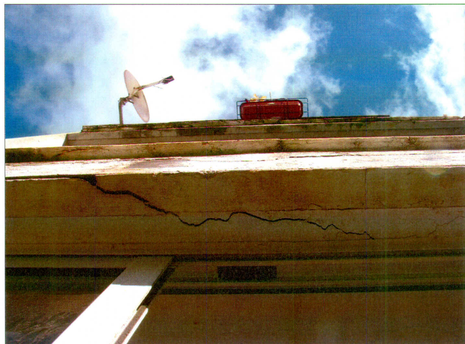
Fisura en borde de forjado en la fachada posterior del inmueble
