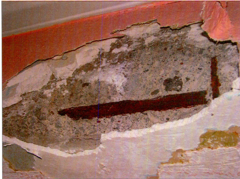
Vista del estado de corrosión que presentaba dicha viga
