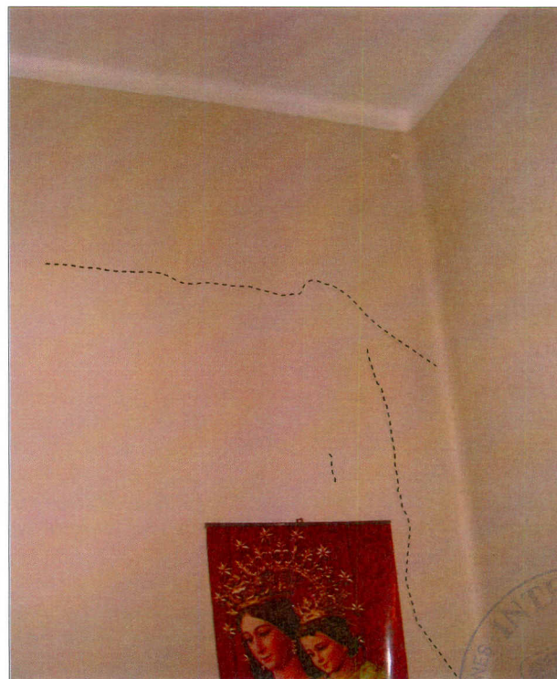
Fisuras de trazado horizontal y vertical en un tabique de la vivienda 2° izquierda
