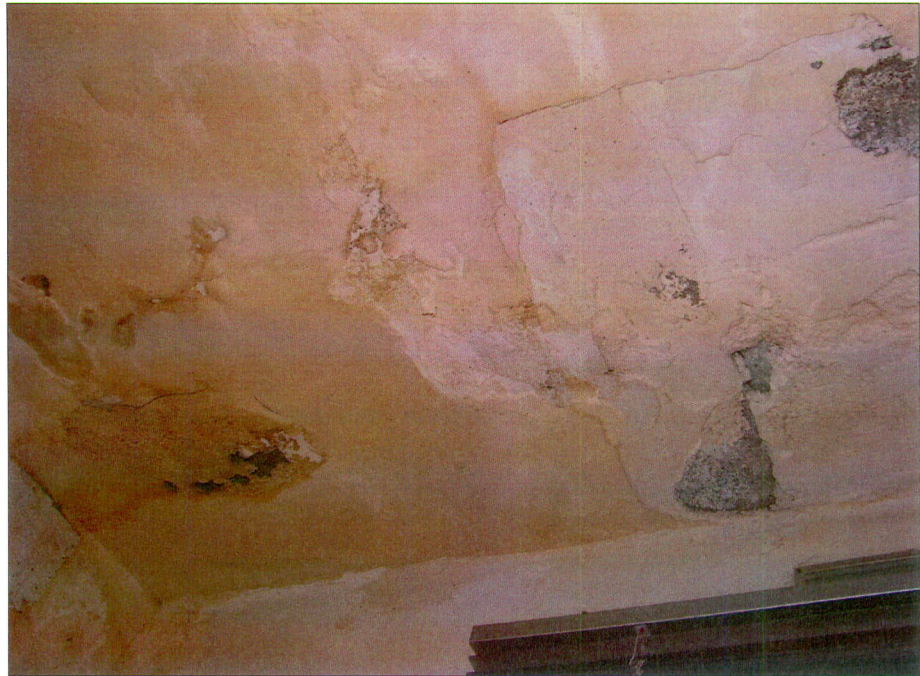
Degradación de acabados por humedades
