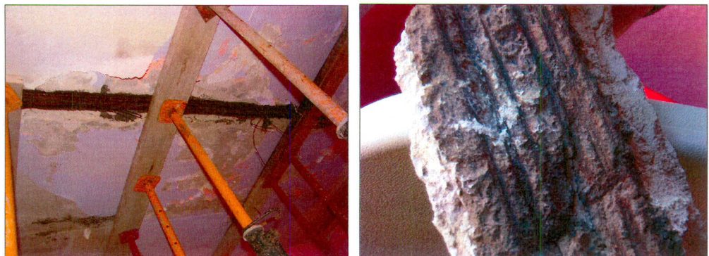
Desprendimiento del recubrimiento de alguna de las viguetas del forjado de techo de la vivienda 4° izquierda
