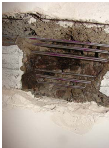
Estado de la vigueta tras la aplicación de fenolftaleína diluida.
