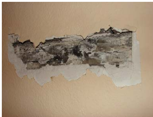
Vista a la cala realizada. Fisuración elevada longitudinal del ala inferior de la vigueta descubierta.
