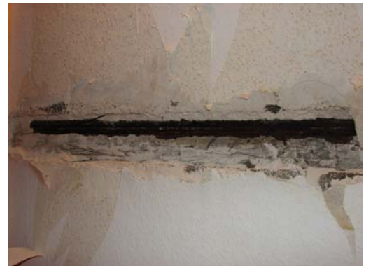
Vista de la cala realizada. Corrosión avanzada de los alambres. Pérdida de sección hasta rotura.
