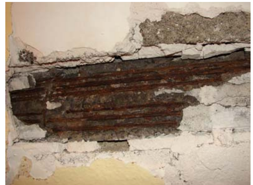
Vista de la cala realizada. Corrosión avanzada de los alambres. Pérdida parcial de sección.
