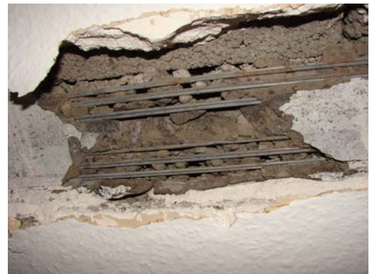
Vista de la cala realizada. Leve corrosión superficial de los alambres.
