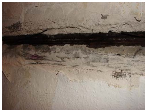
Estado de la vigueta tras la aplicación de fenoltaleína diluida.
