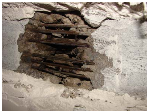
Estado de la vigueta tras la aplicación de fenolftaleína diluida.
