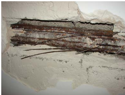
Corrosión avanzada de los alambres de la vigueta. Pérdida de sección hasta rotura.
