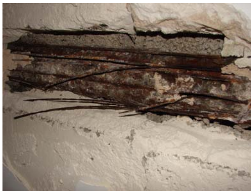
Estado de la vigueta tras la aplicación de fenolftaleína diluida.
