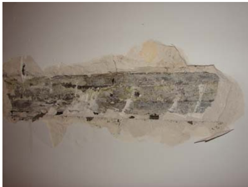
Vista previa a la cala realizada. Fisuración longitudinal del ala inferior de la vigueta descubierta.
