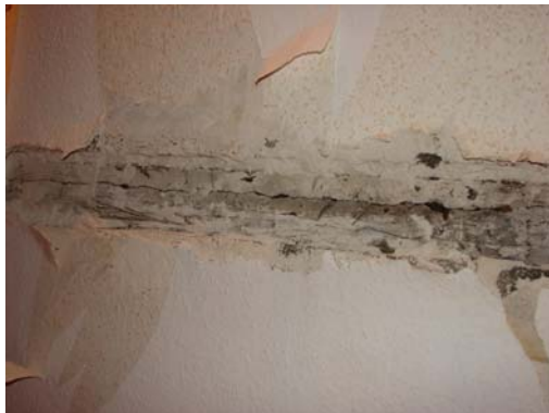
Vista previa a la cala realizada. Fisuración longitudinal del ala inferior de una de las viguetas.
