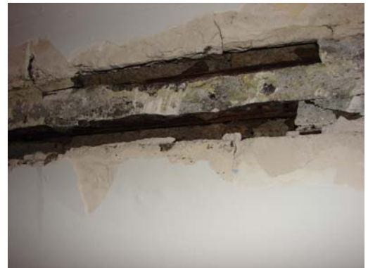
Vista de la cala realizada. Corrosión avanzada de los alambres. Pérdida parcial de sección.
