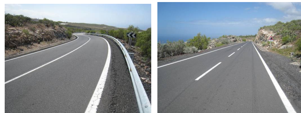
Vistas generales de la carretera TF-465 a su paso por el Sector de Maguenes
