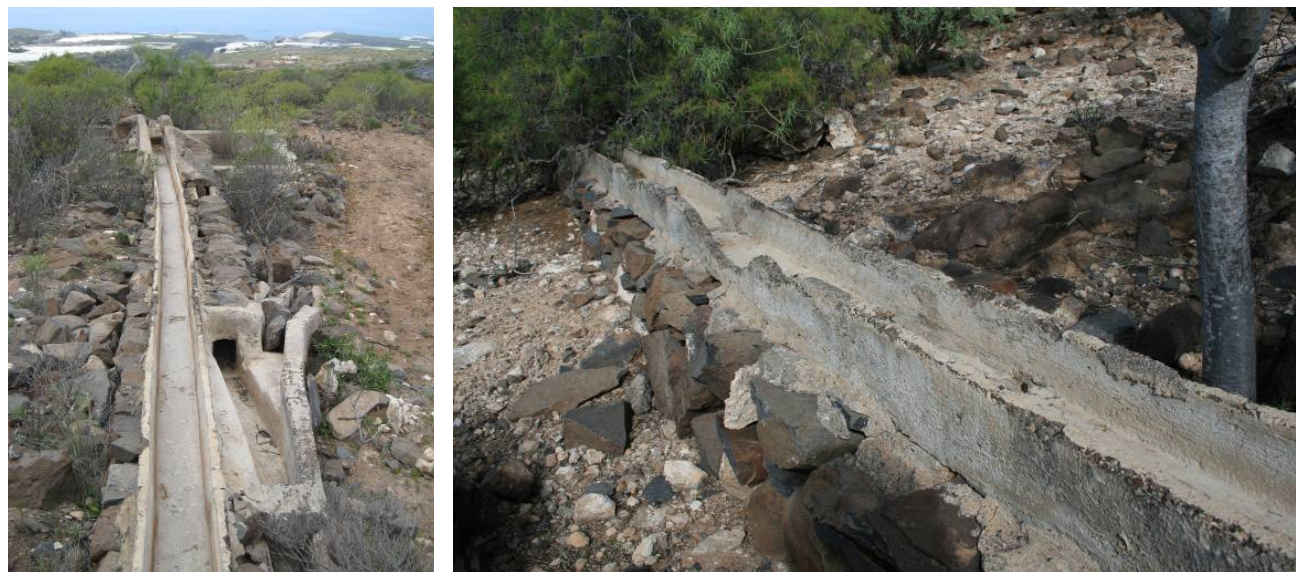
Vista parcial de tarjeas en desuso
