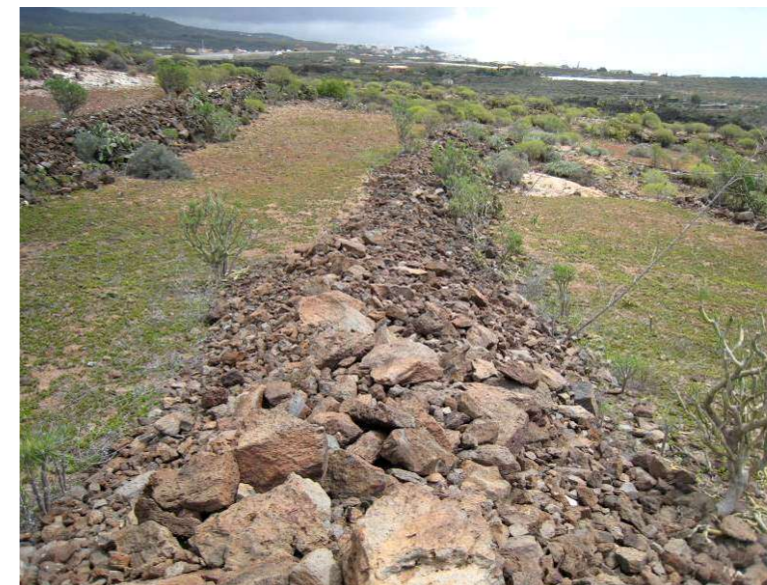
Derrumbe de muros de bancales abandonados
