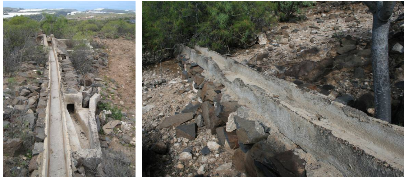
Vista parcial de tarjeas en desuso
