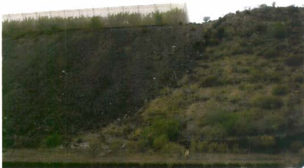
Ejemplo de actuación humana, generadora de movimientos de ladera
