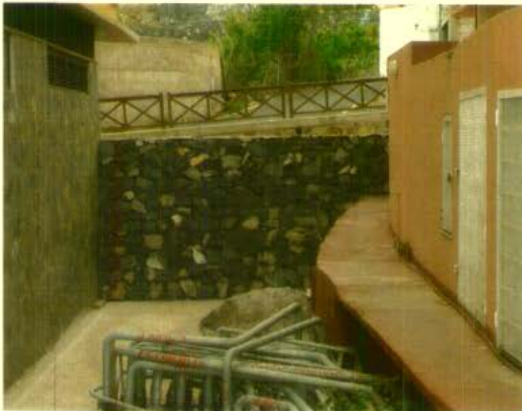
Imagen de pared con tuberías
