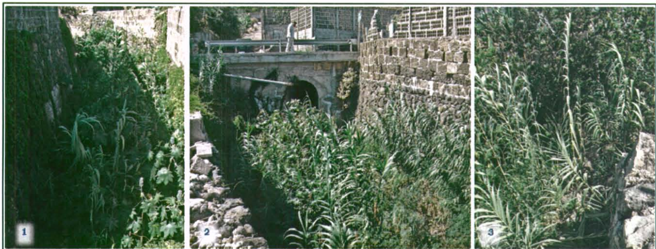
Imagen 10. Tres instantáneas del riesgo de inundación y aluvionamiento del barranco de Correa en el puente de la TF-42: 1. Una sección aguas arriba del cauce ocupada por la vegetación; 2. El puente que atraviesa el cauce donde se observa la ocupación del cauce por la vegetación; 3. Detalle del cauce aguas abajo del puente, la vegetación es un vector de riesgo si se mantiene el cauce en estas condiciones.
