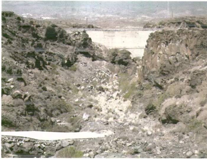
Imagen del estado actual del cauce donde se observan escombros y una pista privada que accede al cauce.
