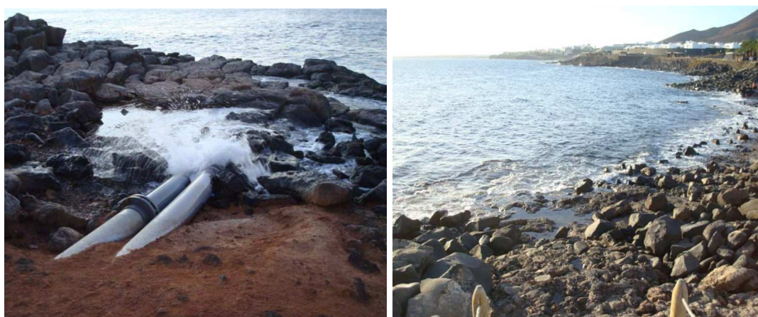
Detalle de los puntos de vertido (salmuera) de Inalsa Sur (LZYA12) y del Club
