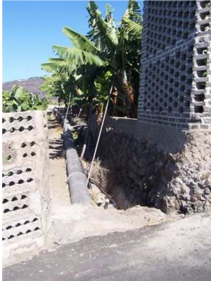
Conducción entubada de agua de riego que recorre el lindero Sur-Oeste del sector.
