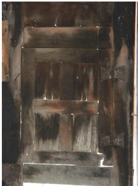
Vista interior de ventanuco. Obsérvese los errajes de visagra
