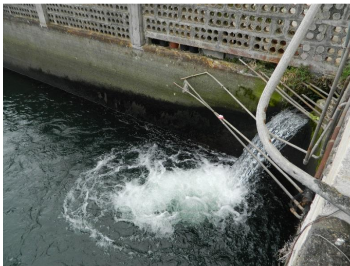
Entrada de agua
