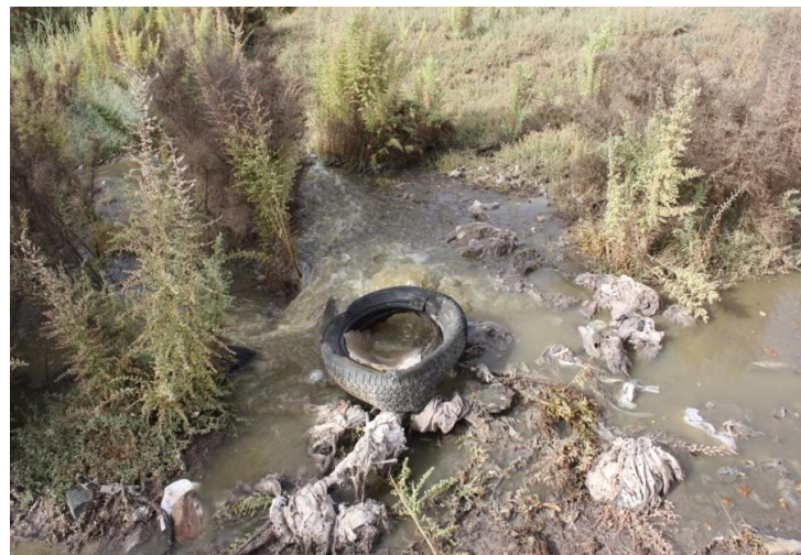
Rotura de tubería del alcantarillado en la parte del ámbito de actuación más próxima a Bellavista. Fuente: Trabajo del campo del presente PMM. Agosto (2014).
