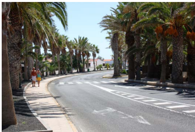
Avda. del Castillo en el tramo próximo al muelle, donde se aprecia un mal estado de conservación del firme
