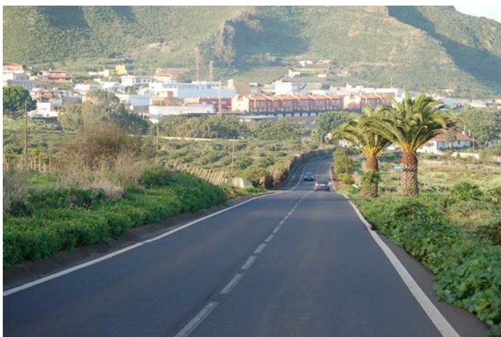
Foto N° 16: Ausencia de acera en el tramo inferior de la TF-154
