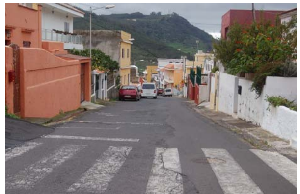
Foto N° 24: Ausencia de acerado y mal estado del firme en el Camino El Monte que da acceso al CEIP Melchor Núñez
