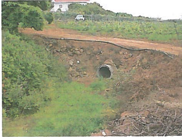
Entubado del barranco de Los Alfonsos bajo el aterramiento creado para cultivo de viña
