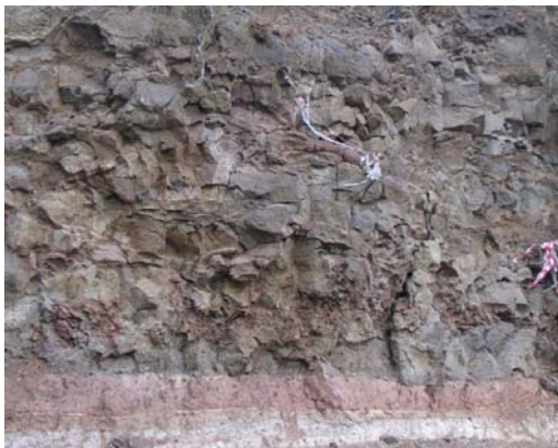
Peligro de desprendimientos por apilación de coladas, en cortes verticales de carreteras. San Francisco Javier
