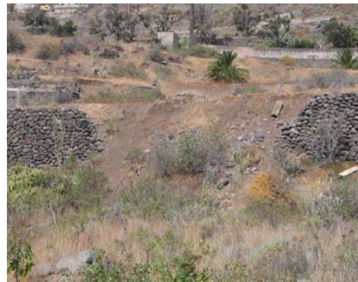
Desprendimientos por caída del muro de un balcón en abandono. Barranco Tenoya
