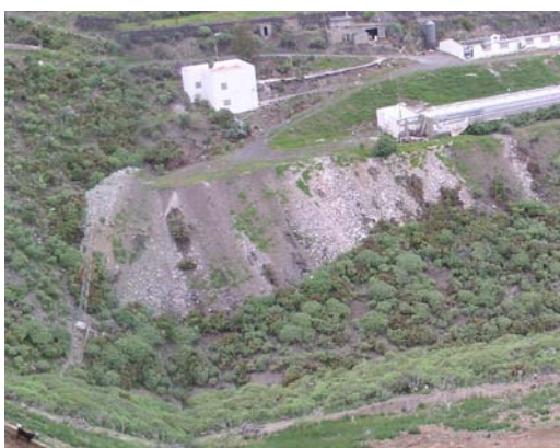
Talud sobre vertiente de barranco y granja avícola en abandono. Urb. San Fernando-Lomo de Arucas
