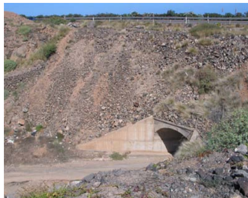
Talud de carreteras sobre cauce de barranco. GC-2 en Rosa Silva
