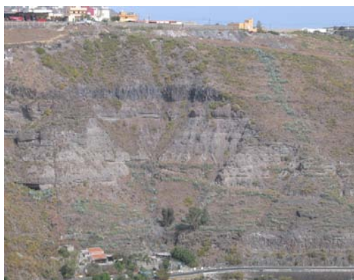
Riesgo erosivo por desprendimientos en vertientes acentuadas sobre materiales deleznable (Formación detrítica Las Palmas). Lomo Grande
