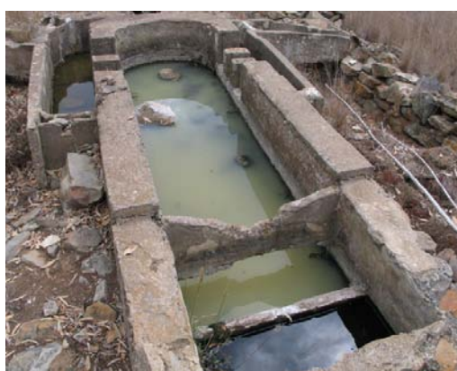
Vertido de aguas fecales al aire sobre infraestructura hidráulica. Lomo de Riquiáñez
