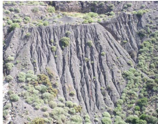
Ejemplos de procesos erosivos sobre taludes, en este caso incisiones o cárcavas. El Portichuelo
