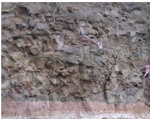
Peligro de desprendimientos por apilación de coladas, en cortes verticales de carreteras. San Francisco Javier
