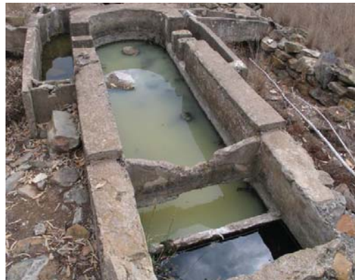
Vertido de aguas fecales al aire sobre infraestructura hidráulica. Lomo de Riquiáñez
