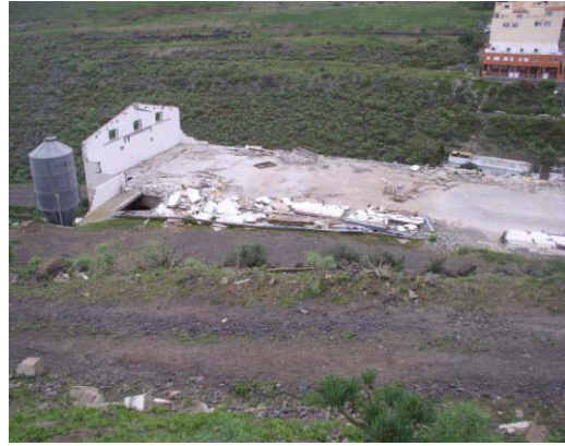
Granja avícola en abandono con un gran deterioro de sus instalaciones. Lomo Grande
