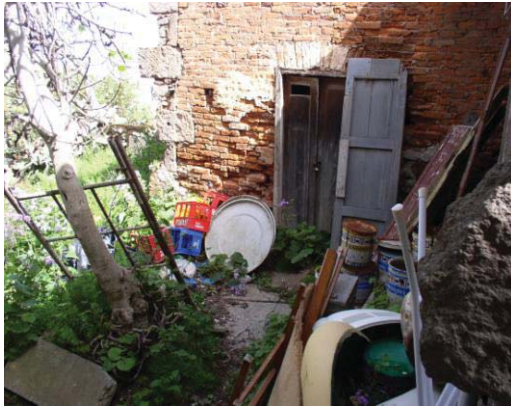
Acumulación de vertidos sólidos en solares sin edificar o en viviendas en estado ruinoso. La Goleta
