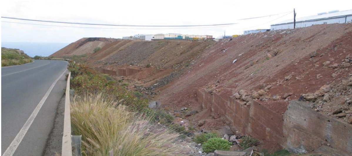
Taludes sin medidas de integración paisajística. Área industrial de Montaña Blanca
