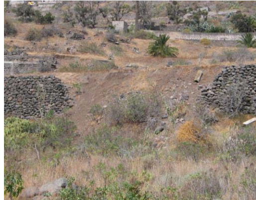
Desprendimientos por caída del muro de un bancale en abandono. Barranco Tenoya
