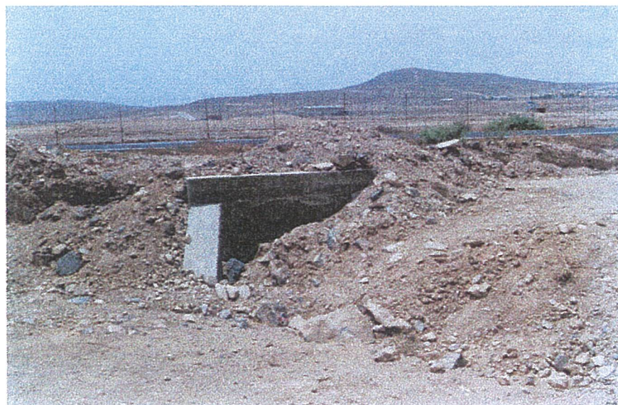
Obra de paso obstruida
